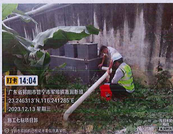
施工七标项目部厨房生活污水
